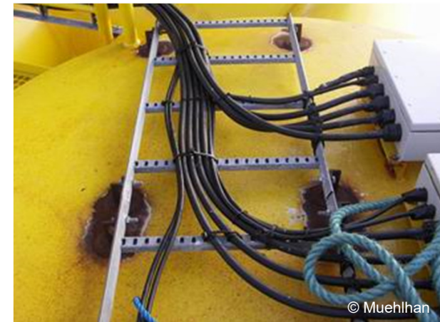
Beispiel für Schäden an Beschichtungen durch geschweißte Halterungen im Offshorebereich
