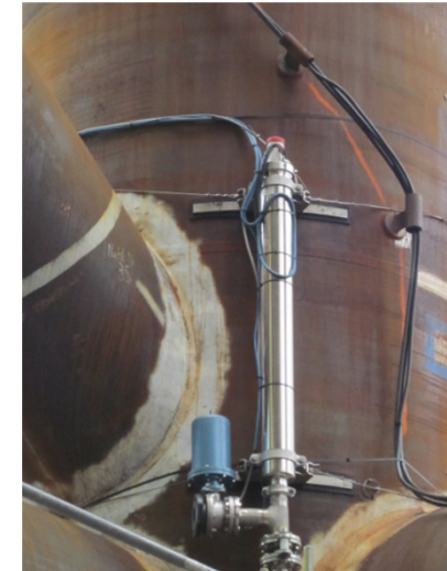
Kabelhalterungen (geschweißt) und Fremdstromanode an Jacket-Struktur
