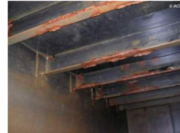
Korrosionsbeginn an freien Kanten im Ballastwassertank
